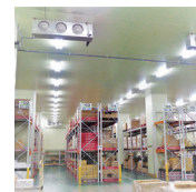
庫内に設置された次世代LED照明
