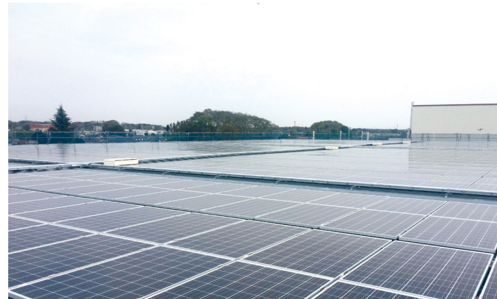
野田物流センターに設置した太陽光発電システム
